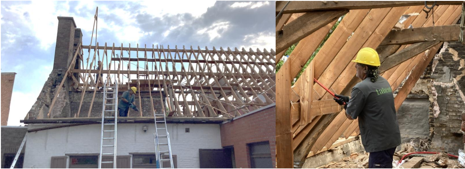
Foto's uit Hergebruik in de praktijk: van ontmanteling tot (her)gebruik: Gids voor sloop- en afbraakbedrijven (FCRBE) download © Huismus en Labeur
